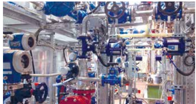
Kläranlage Ruhleben Rauchgasreinigung
