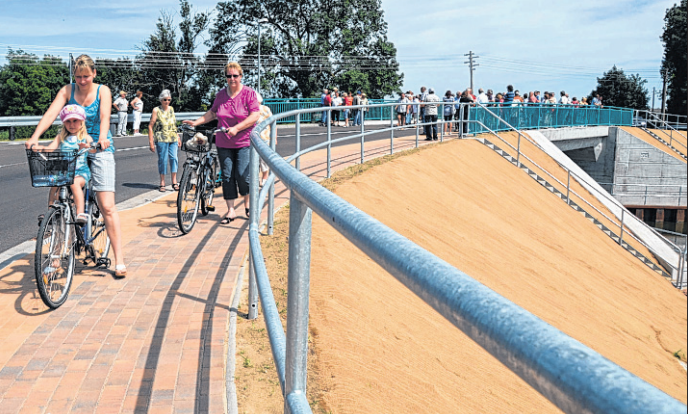
Blick von der Pareyer Seite auf die neue Brücke. Die Rampen auf beiden Seiten wurden mit erneuert, weil sie baufällig waren. Die Böschungen sind mit Matten gesichert, durch die bald Gras wächst.
