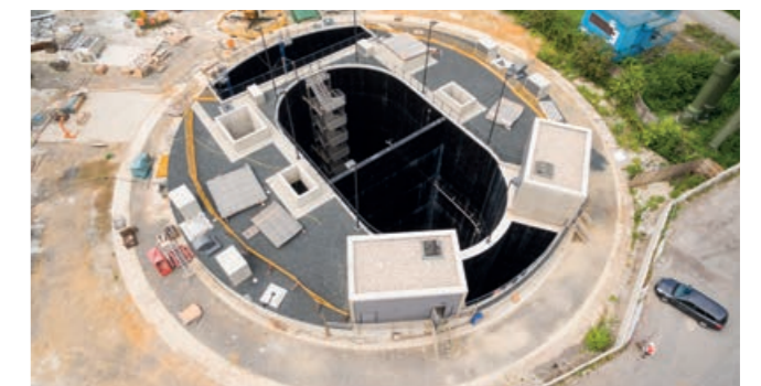
Blick auf das Pumpwerk Gelsenkirchen
