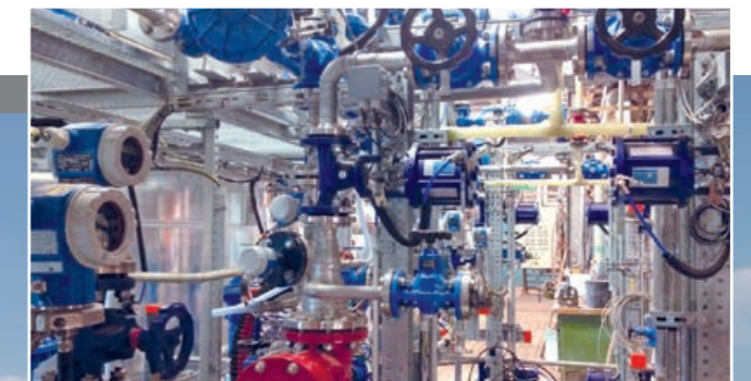
Kläranlage Ruhleben Rauchgasreinigung
