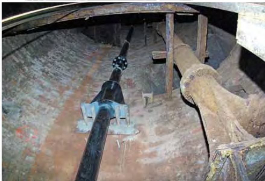
Alte und neue Steigleitung im Schacht
