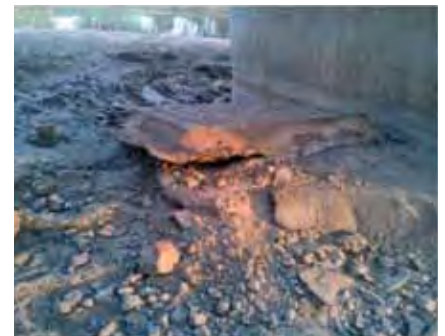
Schäden nach Ablauf des Hochwassers: Auskolkungen an den Widerlagern
