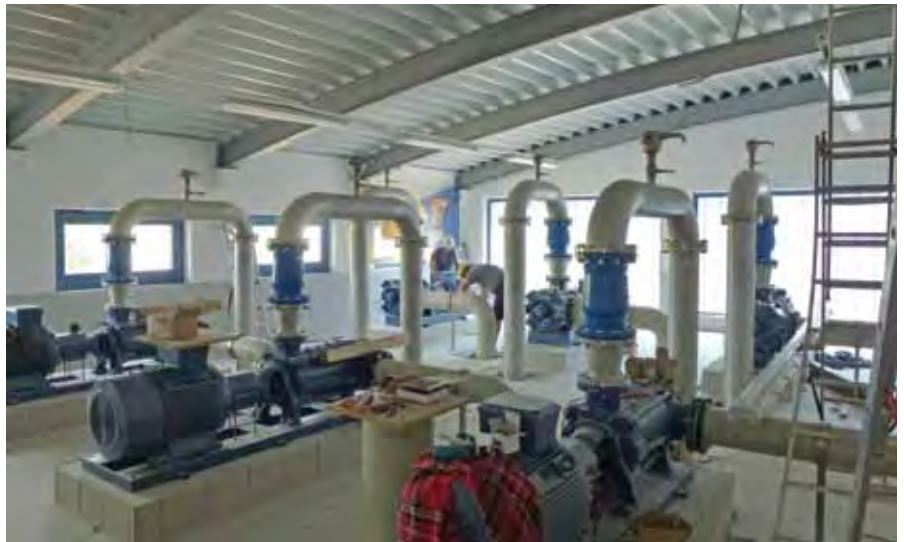
Blick auf die Hochdruckpumpen
