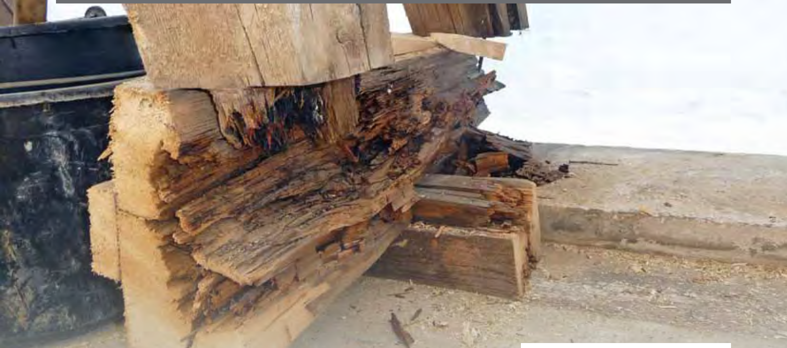
Schwammbefallenes Detail der Dachkonstruktion
