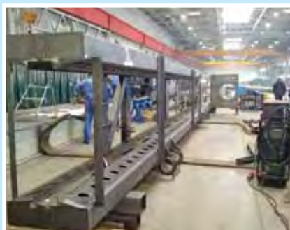
RBT 90 Außenmast in der Werkstattfertigung
