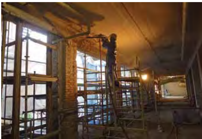
Im Vordergrund Uwe Strümper beim Spritzbetonauftrag der Unterzüge, im Hintergrund Peter Nöldge bei der Beräumung der Abbruchmassen
