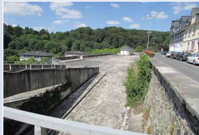
August 2014 vor der Instandsetzung
