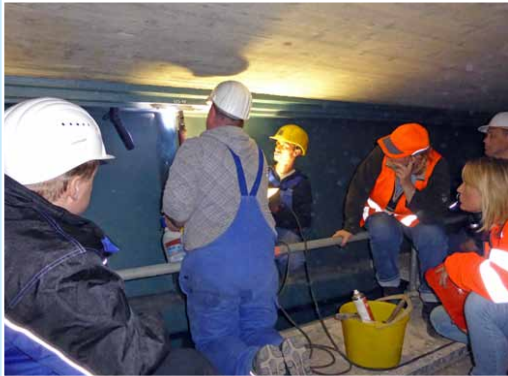
Jörg Holzapfel, Tino Höche, Sebastian Stockhaus, Barbara Kund und Anke Hawemann (beide LSBB) und Burkhard Senk bei der Schadensaufnahme
