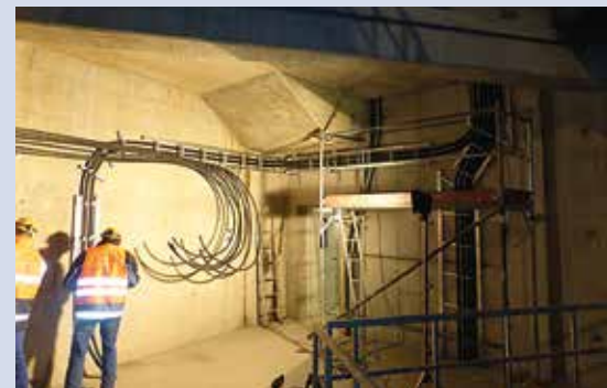
Sebastian Jurchen und Ralf Köthe (v. l.) bei der Montage von Hydraulikbündelrohren auf der Baustelle in Gelsenkirchen
