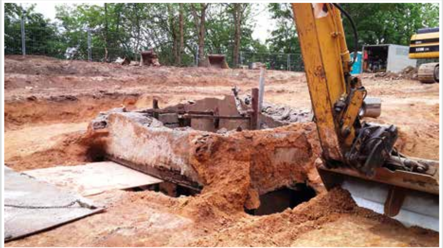
Zusammengebrochener Schachtkopf mit Ausbrüchen an den Stößen bei der Erstbefahrung
