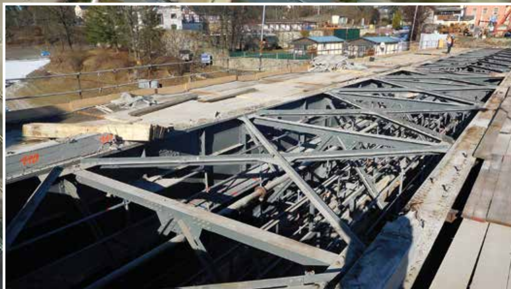
Stahltrug nach abgebrochener Betonfahrplanplatte
