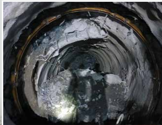
Kollabierter Ausbau mit Schlammereinbruch infolge einer unbekanntenen Explorationsbohrung am 11.12.2014
