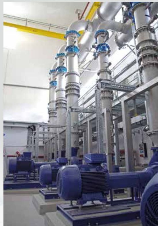
Pumpstation in der Filteranlage
