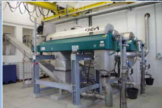
Zentrifugen Anlage im Betriebsgebäude
