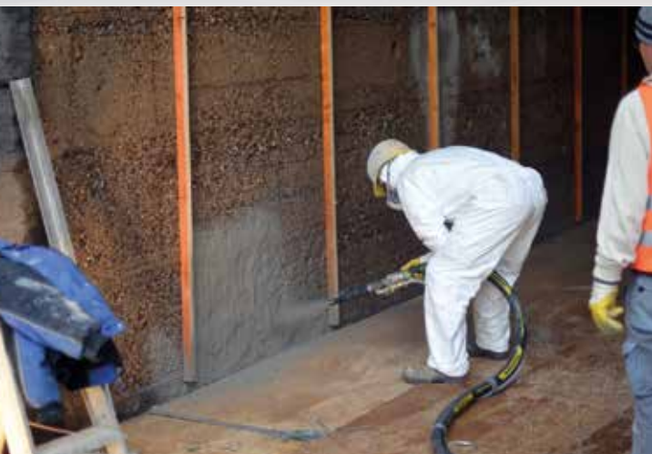
Der erste der 22.000 m 2 wurde am 22. November 2016 durch den langjährigen Düsenführer Peter Nöldge appliziert
