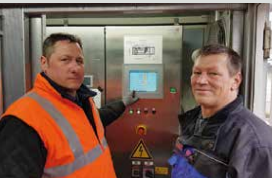
Betrieb der mobilen Schlammabtrennungsanlage (mit Zentrifuge und Verladung) durch Oliver Papst (links) und Peter Fröhlich während der Bauzeit.
